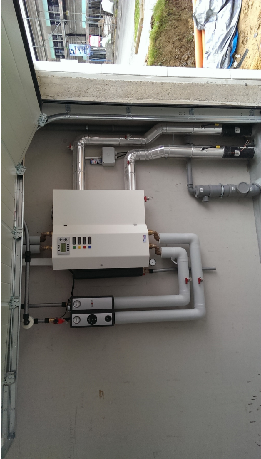
Station de transfert Giro < 70 kW installée dans un garage
